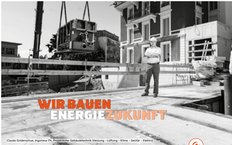
Claude Goldenschue, Ingenieur FH, Projektleiter Gebäudetechnik (Heizung – Lüftung – Klima – Sanitär – Elektro)
